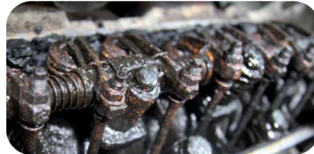
Korrosion am BHKW
